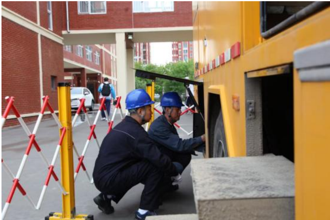
黑河供电公司保电人员在黑河市第一中学考点开展发电车电缆调试
